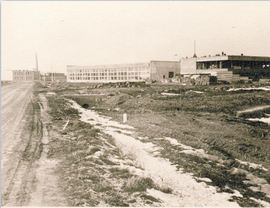
Enne: vaade Kirovi kolhoosi automajandi ja moeateljee hoonete ehitustöödele 1970. aastal (Viimsi Muuseumide fotokogu).
