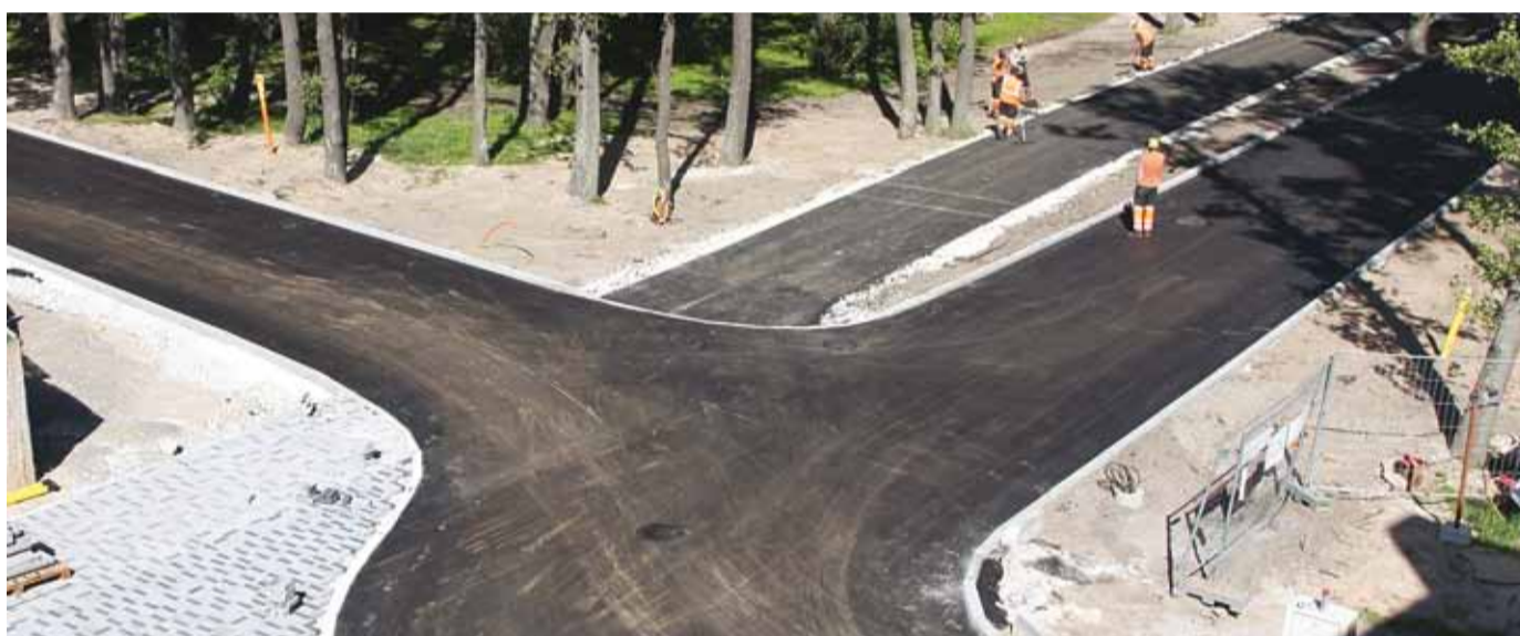
Kesk tee rekonstrueerimistööd lõigul Lepa tee kuni Haabneeme rand on jõudmas lõpuni. Foto Liina Rüütel
