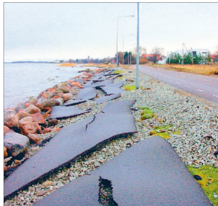
Viimsi-Rohuneeme jalgratta- ja jalgteel on 1,2 km ulatuses ära uhitatud asfaltkate ja osaliselt hävinenud kaldakindlustus.
