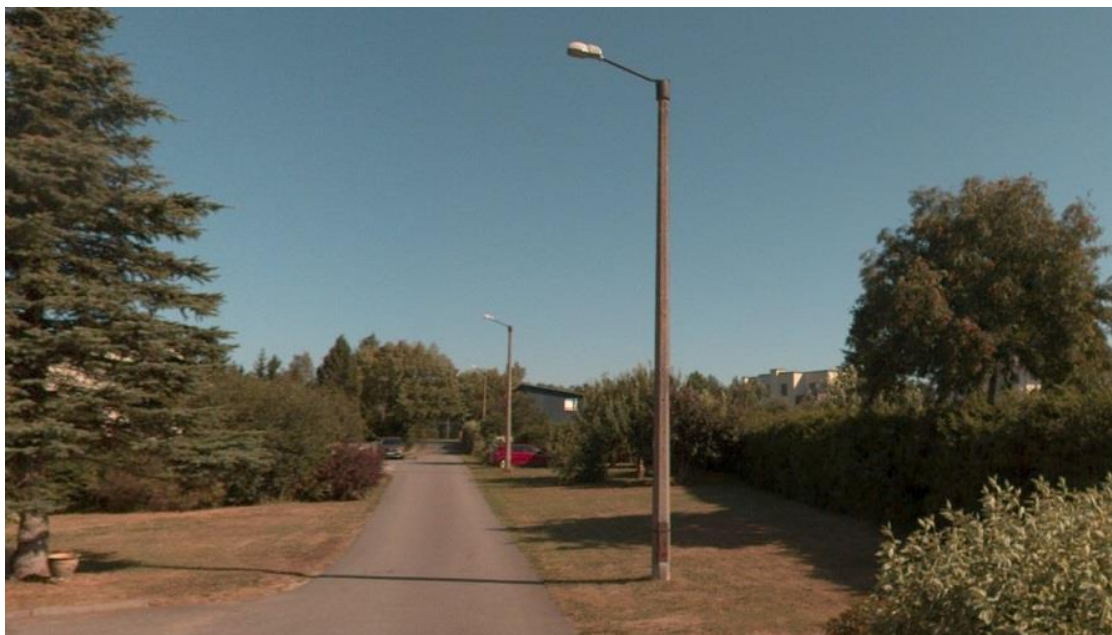
Foto 10. Vaade Priimula teel asuvatele raudbetoonist amortiseerunud mastidele, mis renoveeriti Viimsi valla LED II projekti raames
