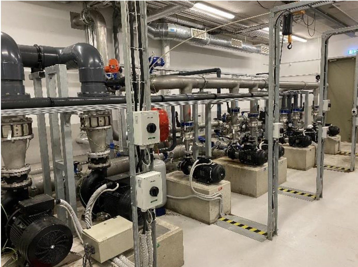
Foto 4-5 Viimsi veetöötlusjaamaga samas hoones paikneb II astme ehk võrgupumpla (pumplas on neli võrgupumpa, kaks tuletõrjepumpa ning kaks pesuveepumpa, arvestusega, et iga valdkonna kohta on üks pump reservis)
