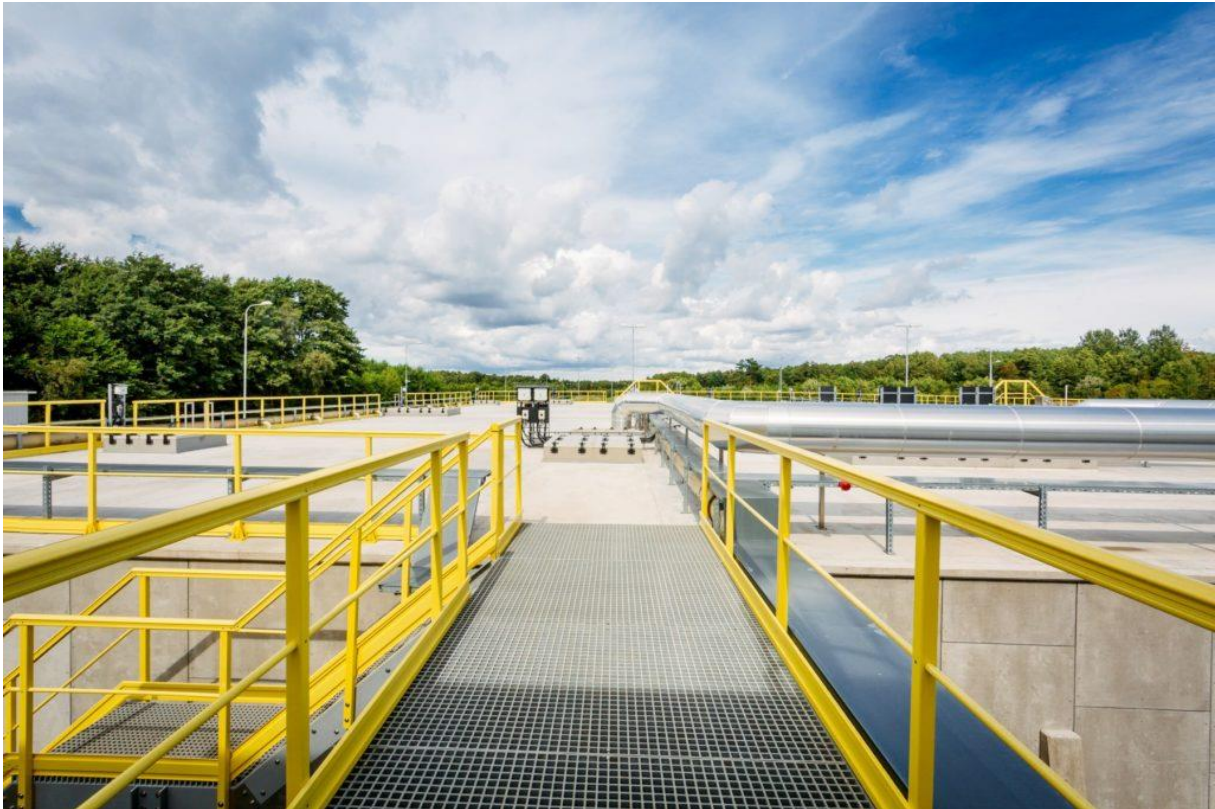
Foto 5-3 Viimsi (Muuga) reoveepuhasti tehnoosa üldine vaade
